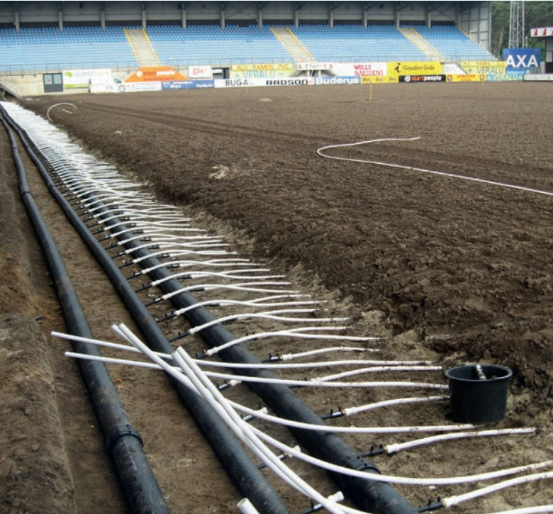
▲ Fußballstadium, Westerlo, Belgien Fußballfeldheizung
