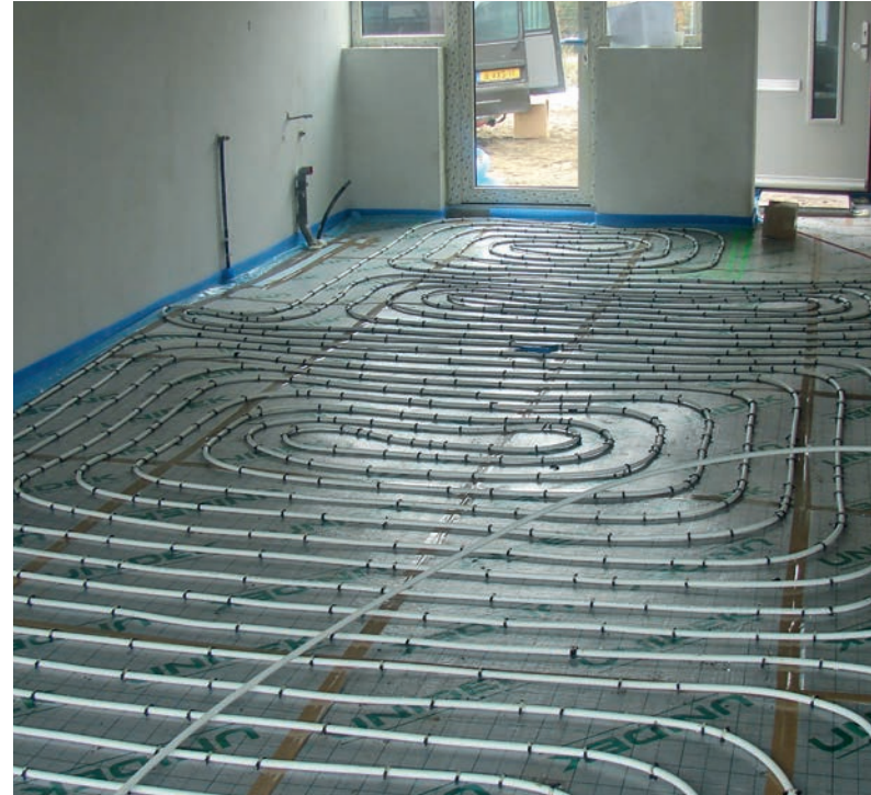
Schouten, Niederlande ▲ Fußbodenheizung
