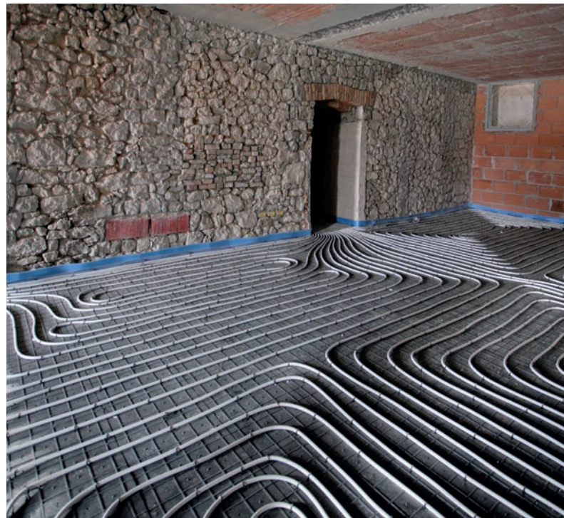
Château, Italie ▲ Chauffage par le sol
