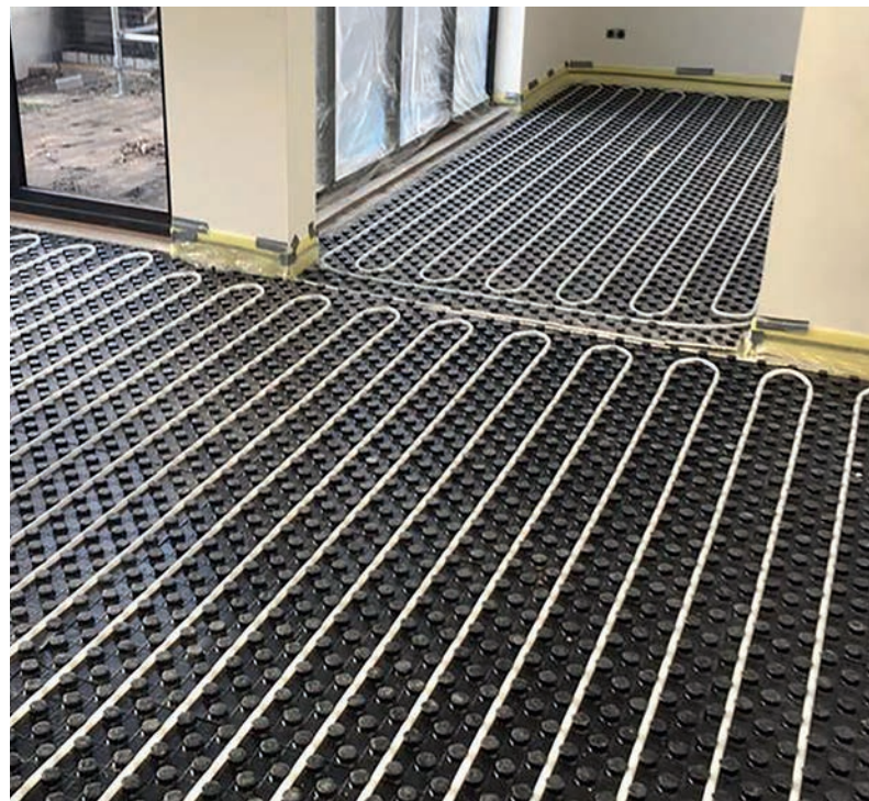
Breda Pays-Bas ▲ Chauffage par le sol
