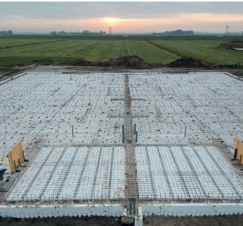
▲ Projet Lemmer, Friesland, Pays-Bas Chauffage par le sol
