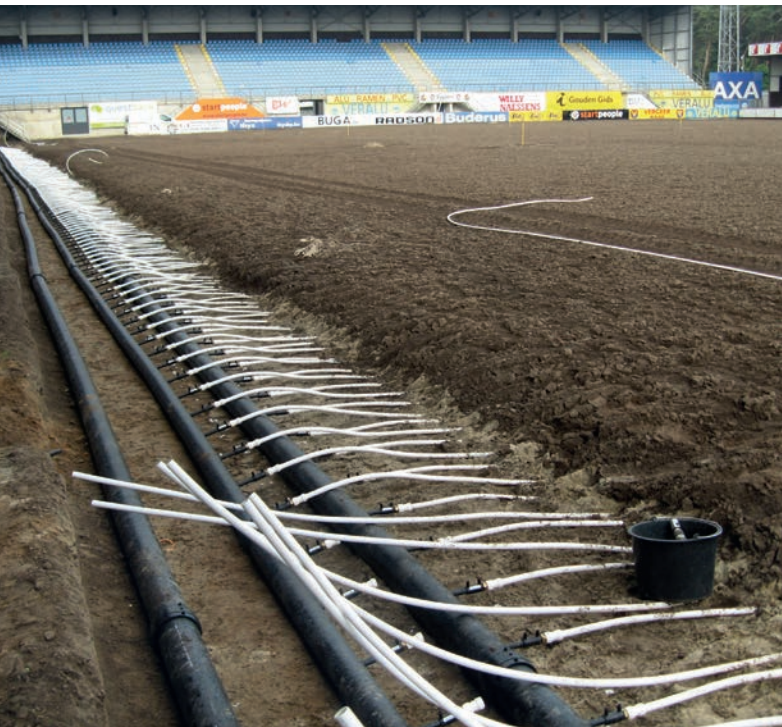
▲ Voetbalstadium, Westerlo, België Voetbalveldverwarming
