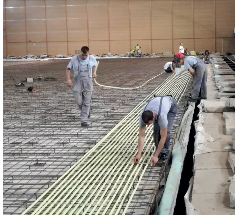
▲ Rink Stadium, Zagreb, Kroatië Koelingsysteem voor indoor schaatsbaan
