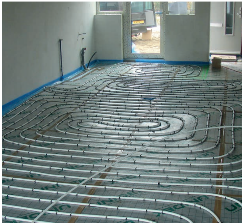
Schouten, Nederland ▲ Vloerverwarming
