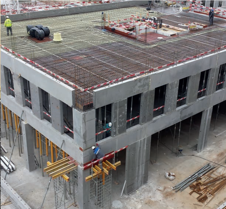
▲ Post X, Antwerpen, België. Betonkernactivering
