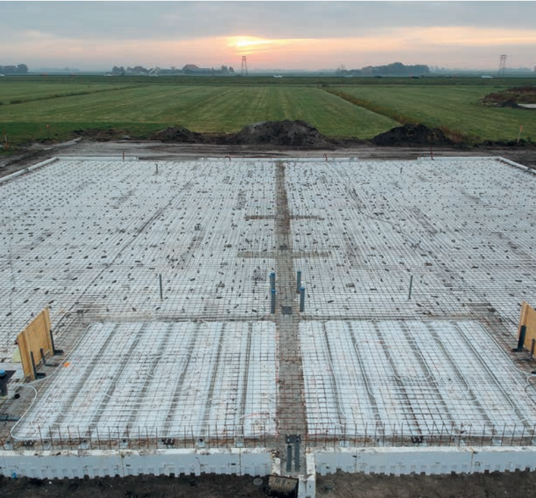
▲ Project Lemmer, Friesland, Nederland Vloerverwarming
