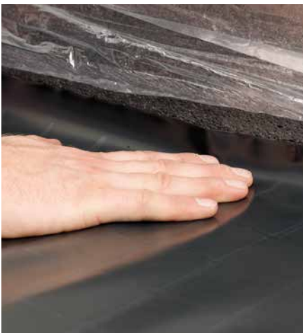
De PE folie wordt opgezet aan de wanden: zodoende heeft men een goede overlapping met de PE flap van de randisolatie.
